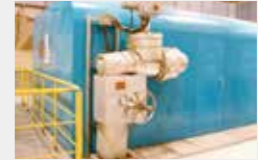
蒸気タービン発電機
