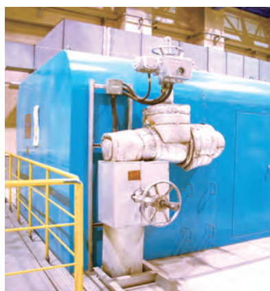
蒸気タービン発電機
